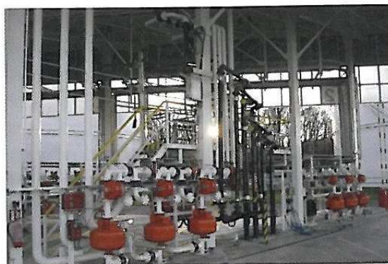
...a jeho výdejní lávky pro plnění autocisteren. Také zde je instalován aditivační systém „EVA“, ...and its tank truck loading rack. Also here are installed additive dosing units „EVA“
